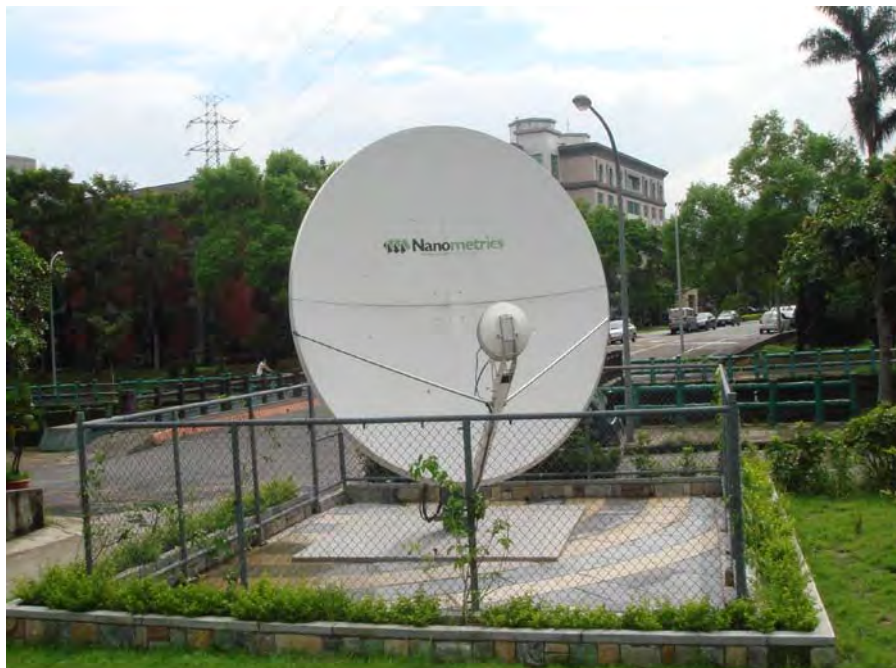
圖二、台灣寬頻網受國科會補助安裝於中研院地球所之衛星中心站接收設備。同樣規格之衛星中心站接收設備(備援中心站)裝設於中央大學。
